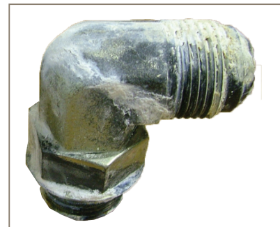
Abbildung 5: Zinkoxidation an einer Stahlrohrverschraubung
