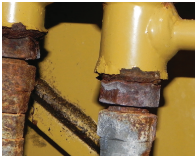
Abbildung 4: Korrosionsübertragung auf angrenzende Bauteile
